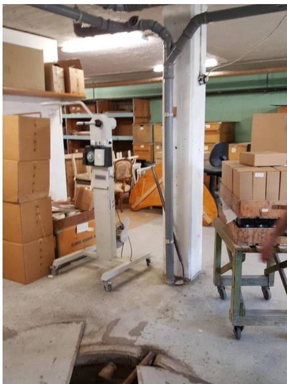
Figur 7 Avloppsledningar från produktionen till sedimentavskiljaren.
